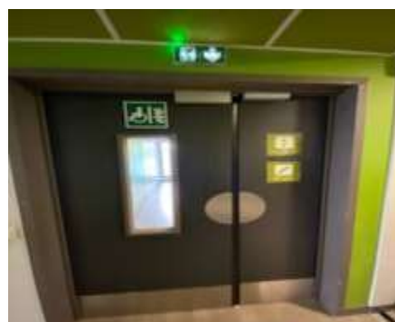
Porte coupe-feu et éclairage de sécurité
