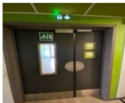
Porte coupe-feu et éclairage de sécurité
