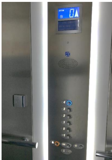
Ascenseur du bâtiment de la direction des sports
