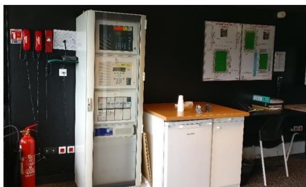
Centrale incendie (PC sécurité)
